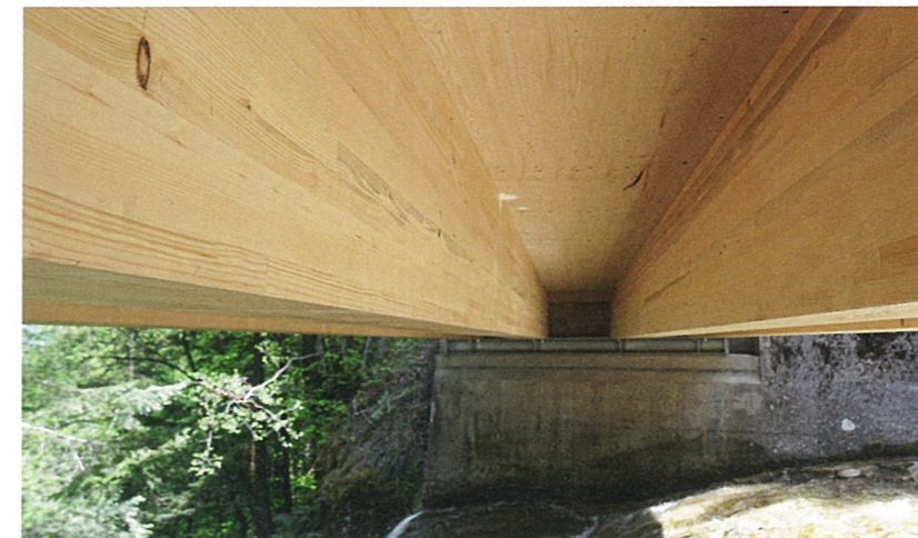
Ganz oben: Querschnitt durch den Widerlagerbereich: Zwischen den Holzträgern dienen Dreischichtplatten als verlorene Schalung.
