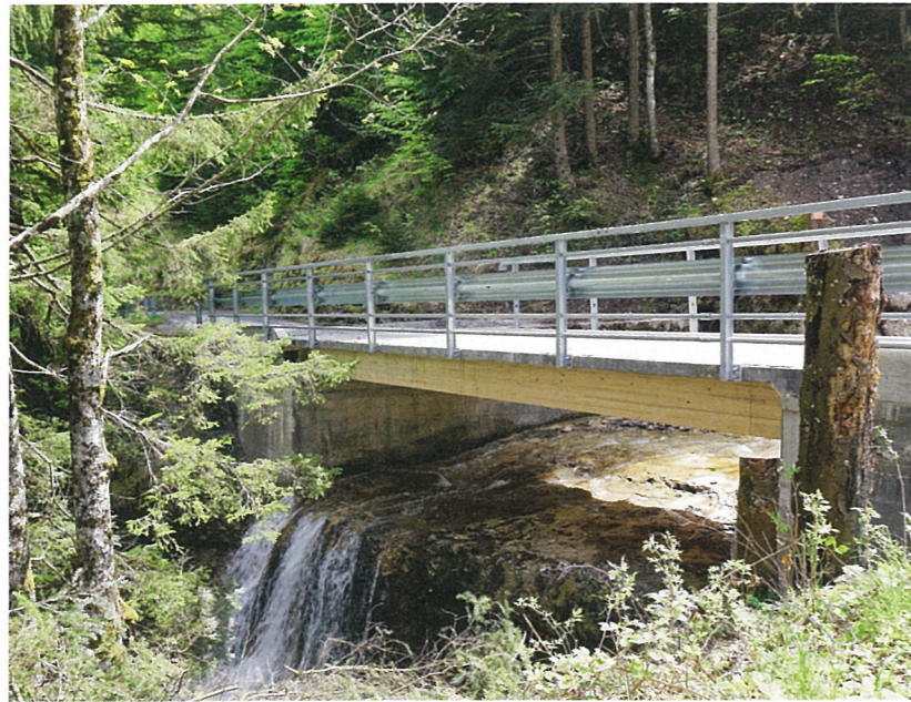
Die Fruttlibrücke in Arth ist die schweizweit erste Holz-UHFB-Verbundbrücke, die für 40-Tonnen-Lasten ausgelegt ist. Sie spielt eine wichtige Rolle im regionalen Holz- und Gütertransport.
