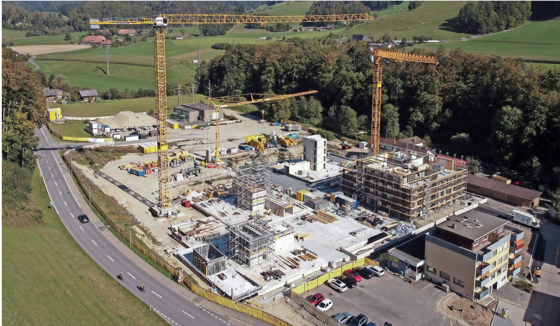
Im Fischermätteli in Burgdorf wird die derzeit grösste Holzüberbauung der Schweiz errichtet. Fotos: Beat Mathys
